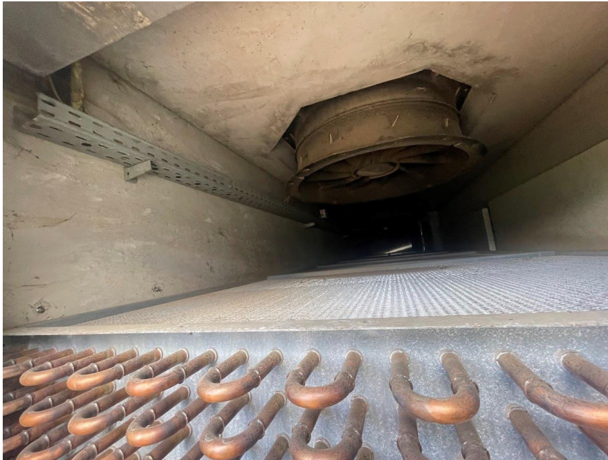
Figuur 7: koelsysteem onder ventilatoren
