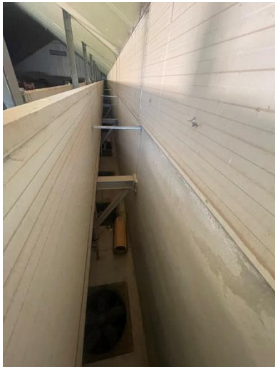
Figuur 6: drukwand met roosters waardoor koeling gemonteerd wordt
